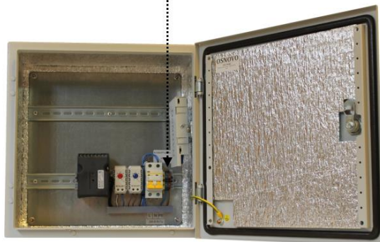
Рис.4 Точка подключения встраиваемого оборудования к сети 220V переменного тока внутри уличной станции с «теплым» пуском на примере модели OS-44H2
